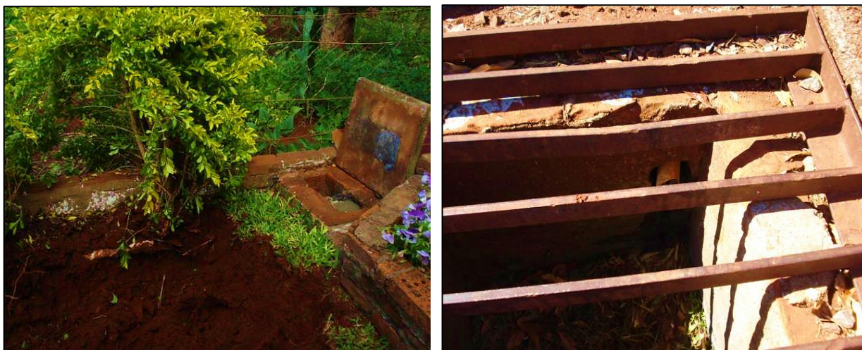
Figura 39. Locais impróprios de lançamento de águas residuárias/servidas. Fonte: Departamento Municipal de Meio Ambiente, 2011.
