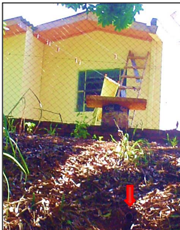
Figura 35. Canos levando esgoto de residências diretamente no curso hídrico. Fonte: Vigilância Sanitária Municipal (2013).
