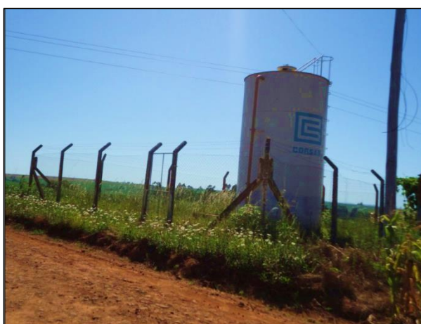
Figura 24. Reservatório Metálico Apoiado R-2. Fonte: Vigilância Sanitária Municipal, (2013).
