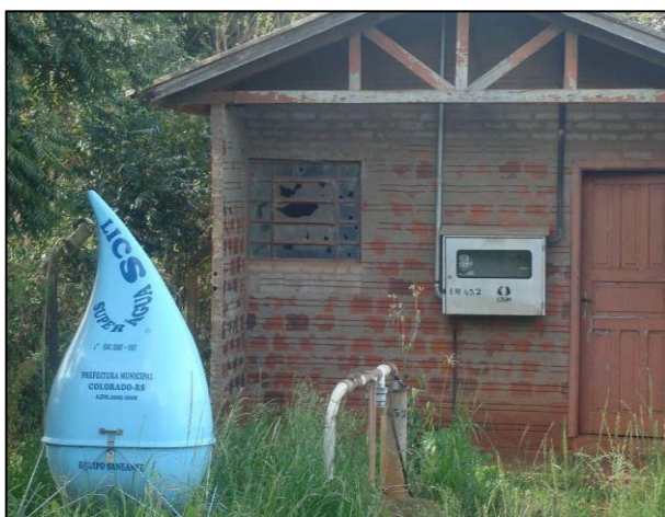
Figura 26. Poços tubulares existentes em Colorado. Vista Alegre, abastece 76 propriedades.
