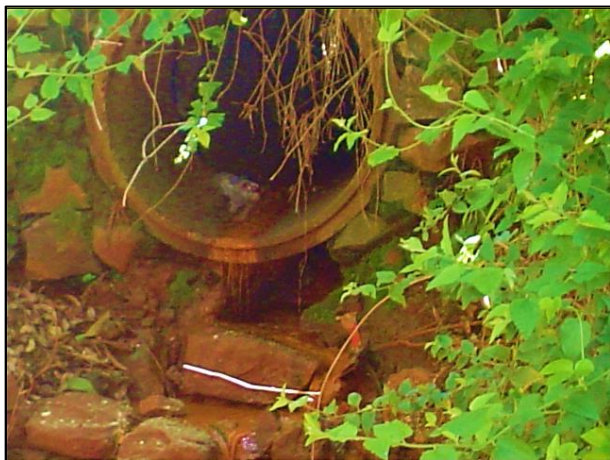
Figura 34. Lixo jogado no sistema de esgoto. Fonte: Vigilância Sanitária Municipal (2013).
