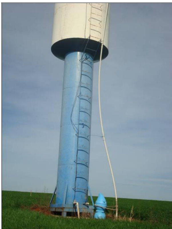
Figura 28. Poços tubulares existentes em Colorado. Linha Coati, abastece 22 propriedades.
